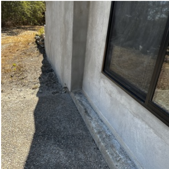
UNEVEN CMU WALL
