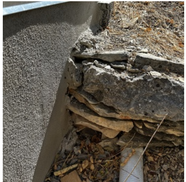
LOOSE STONE ABUTS STUCCO
