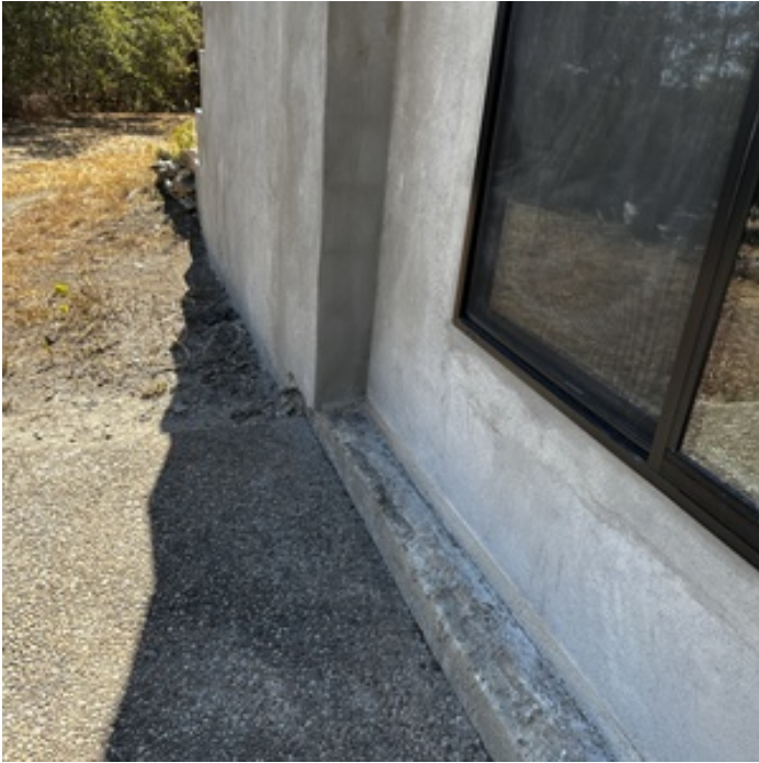
UNEVEN CMU WALL
