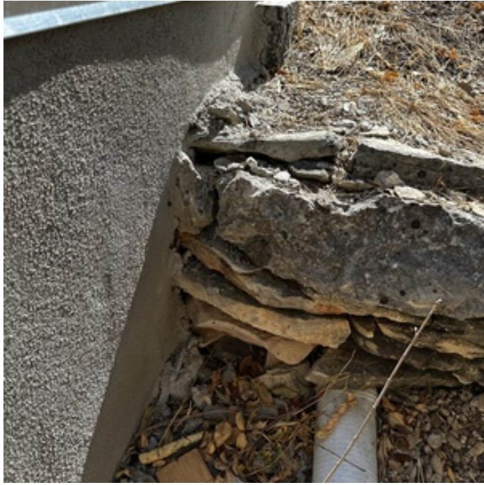
LOOSE STONE ABUTS STUCCO
